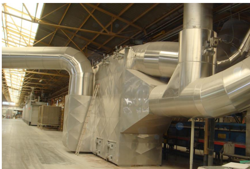
Figura 24. Fotografía de un intercambiador de calor instalado para la recuperación de calor de las chimeneas de humos de dos hornos, calentándose aire ambiente para su empleo en secaderos de baldosas.
