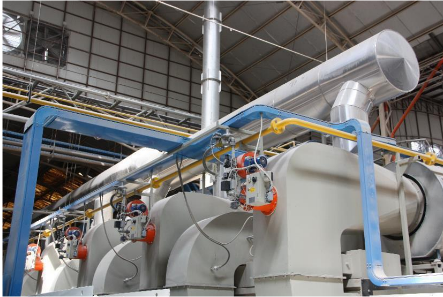
Figura 12. Entrada de gases calientes recuperados en las conducciones de recirculación de un secadero horizontal. (Foto de SACMI)
