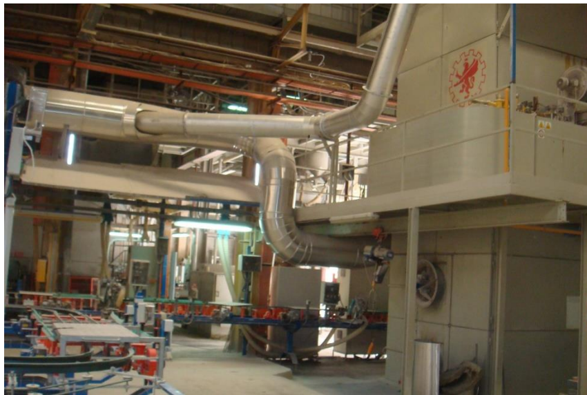
Figura 11. Entrada de gases calientes recuperados a la zona de aporte de gases de renovación
