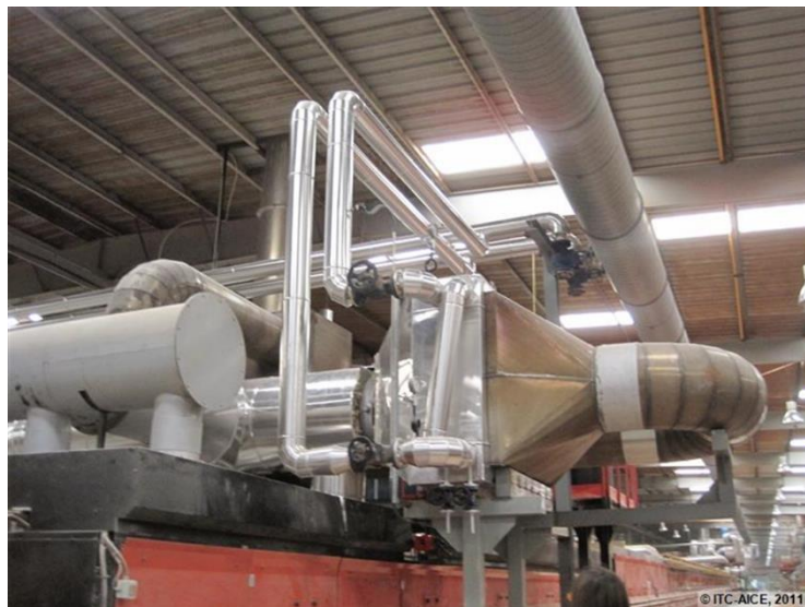
Figura 14. Intercambiador de aceite térmico instalado en la chimenea de humos de un horno.
